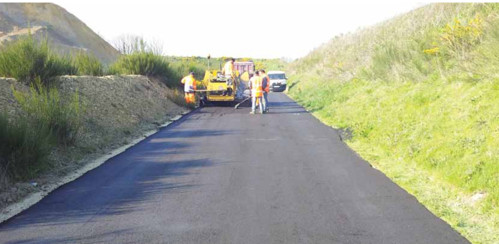
Mise en œuvre de graves-émulsion de reprofilage 0/6 et 0/10 sur une voirie lourde de carrière. L'absence visible de fumée à la mise en œuvre illustre le bienfait pour les consommations d'énergie et montre l'intérêt pour les travailleurs.
