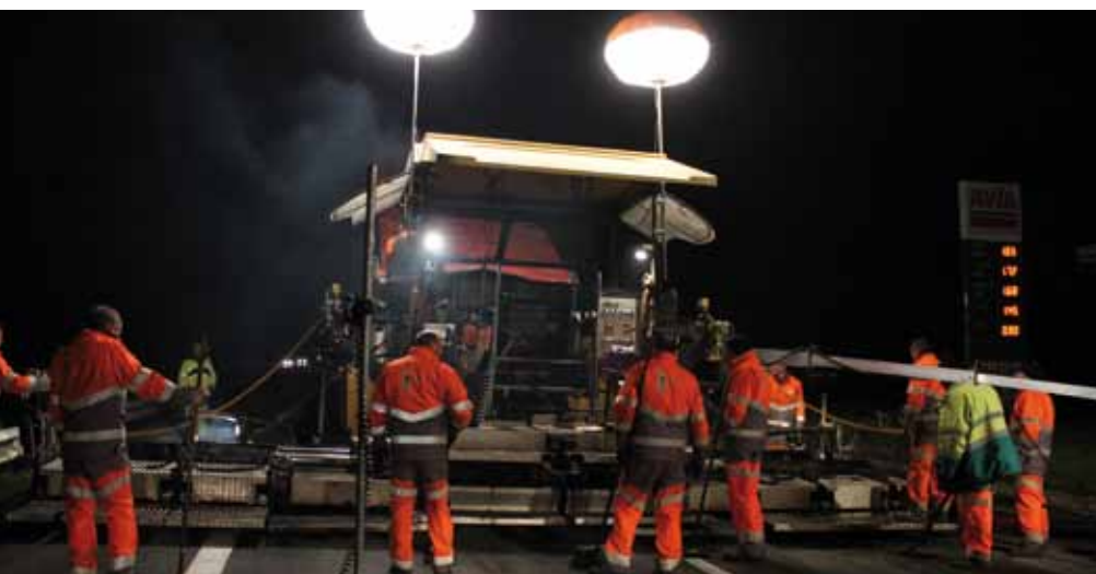
Chantier de nuit, RN171 avec les nouveaux vêtements de travail Haute visibilité de l'Entreprise CHARIER
