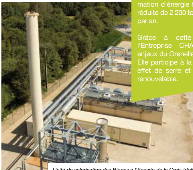
Unité de valorisation des Biogaz à l'Ecosite de la Croix Irtelle
